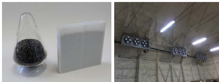
図3. 野菜貯蔵庫の空調送風口に設置されたプラチナ触媒
